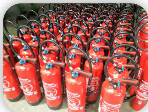
Refonte du déploiement des extincteurs Mise en place d'extincteurs complémentaires
