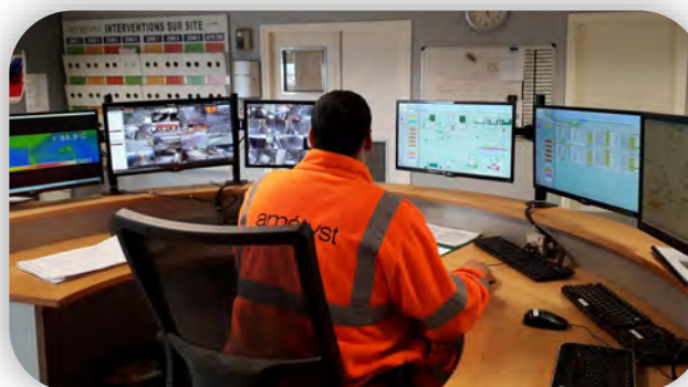
Ecrans de vidéo-protection en salle de commande
